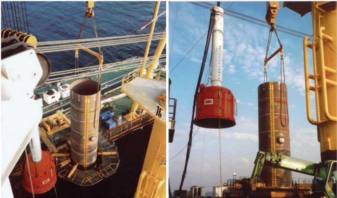
Figuur 5-1 Voorbeeld installatie van een 4,6 m diameter stalen buispaal voor een windturbine op zee (uit Artikel Geotechniek, Kooistra, A e.a., Heivermoeiing van paalfunderingen bij offshore windpark Egmond aan Zee, juli 2008)
