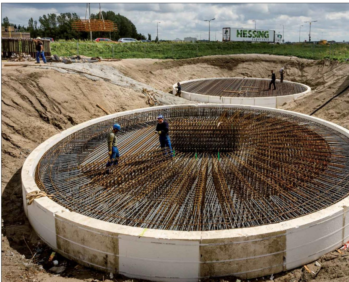
Afbeelding 6. Voorbeeld van een fundering van een hoogspanningsmast en impressie van de hiertoe aangelegde bouwput. Bron: http://www.zuid-west380kv.nl .
